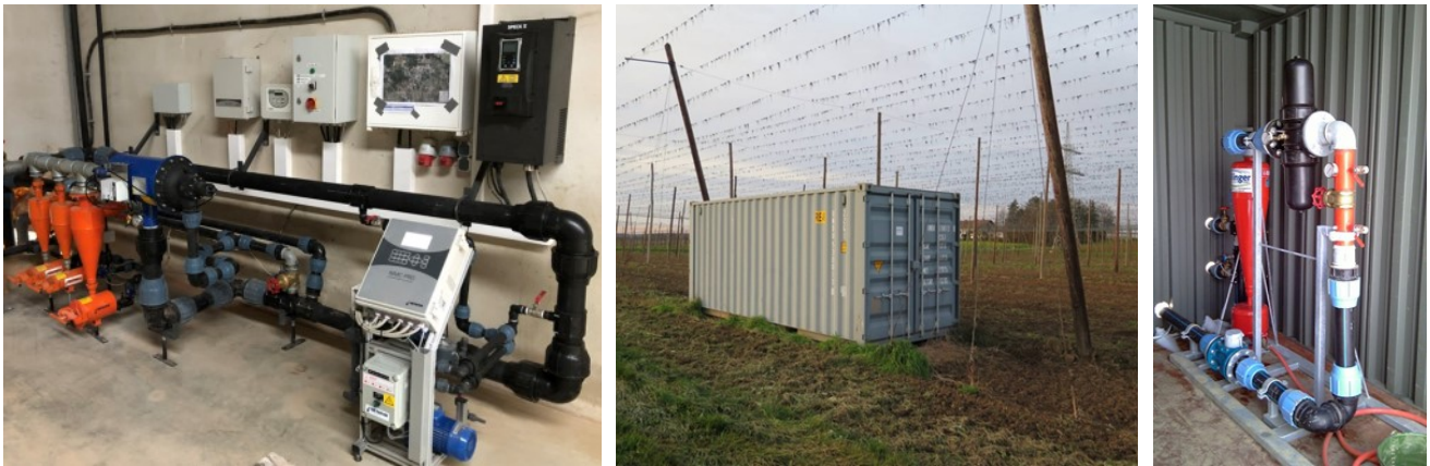
Bild 2, 3, 4: Beispiele für die Errichtung einer Filter- und Verteilstation in einem Gebäude (links) bzw. einem Container (Mitte)
