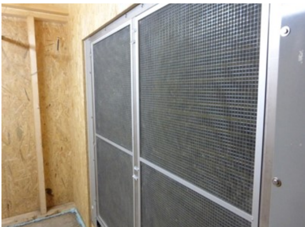
Abb. 7: Luftentfeuchter mit zuluftseitigem Gitter für den Grobschmutz an der Anströmseite des Wärmetauschers (Bildquelle: Markus Hofmann, LfL 2018)
